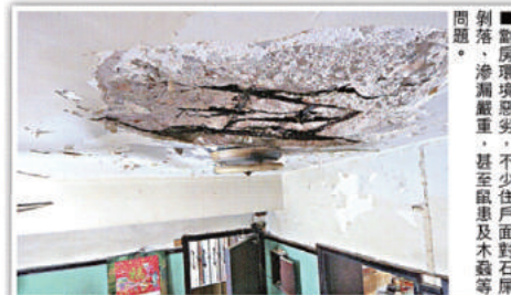
▲劏房環境惡劣，不少住戶面對石屎剝落、滲漏嚴重，甚至鼠患及木蟲等問題。
